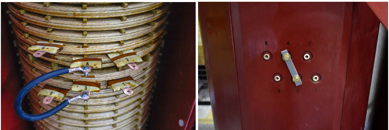
Figure 8: Gauche: prises de tension typiques sur la face de bobine pour le transformateur VPI. Droite : prises de tension typiques sur la face de bobine pour le transformateur de bobine coulé
